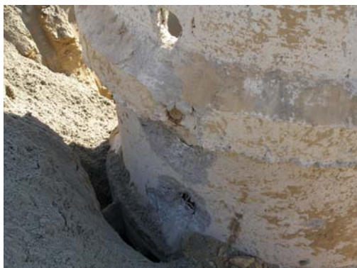
Рис. 3. Отверстия в колодце
