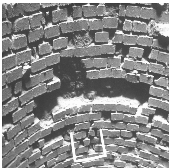
Рисунок 1 – Разрушение кирпичной кладки дымовой трубы
