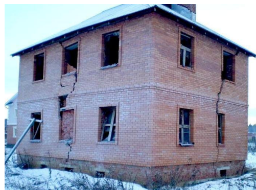
Рисунок 3 – Последствия пучения грунта
