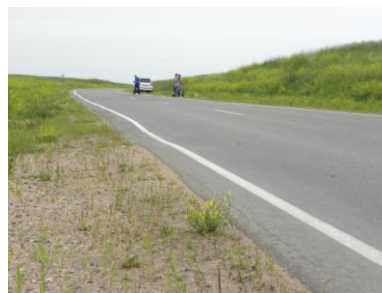
Рисунок 1 – Неровности покрытия на участке ПК7+70 автомобильной дороги «Новотырышкино-Белокуриха»
