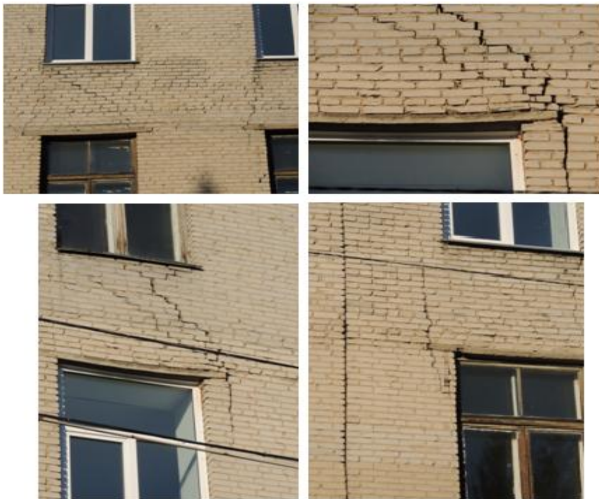
Рисунок 1 – Вертикальные и наклонные трещины в наружной стене с шириной раскрытия до 30 мм
