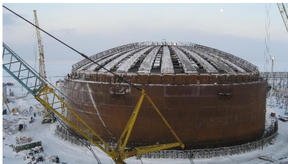
Рисунок 2 – Резервуар вертикальный стальной с понтоном для нефтепродуктов объемом 50 000 м 3
