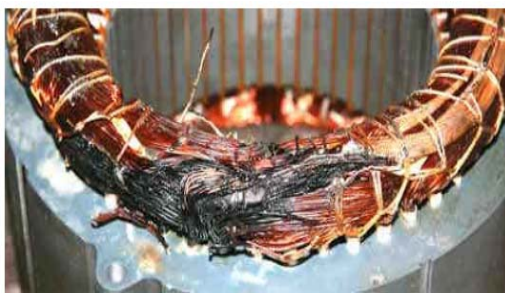
Рисунок 4 - Сгоревшая обмотка мотор-генератора MG2
