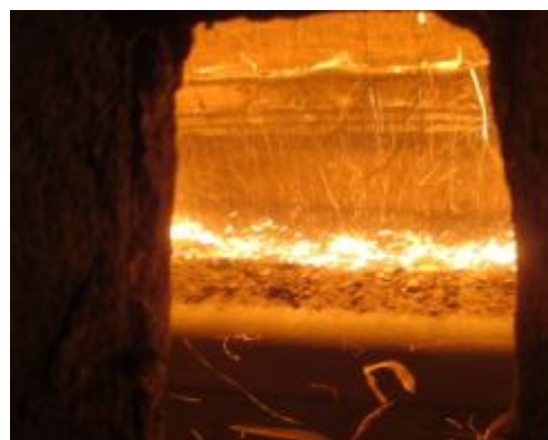
Рисунок 9- Горение провала на дожигателе шлака
